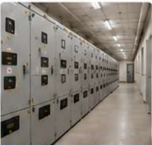
132kV SWITCHGEAR PANELS
